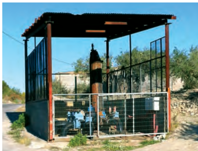
► Bomba hidráulica para extraer el agua por parte de la comunidad de regantes de la Oica.
